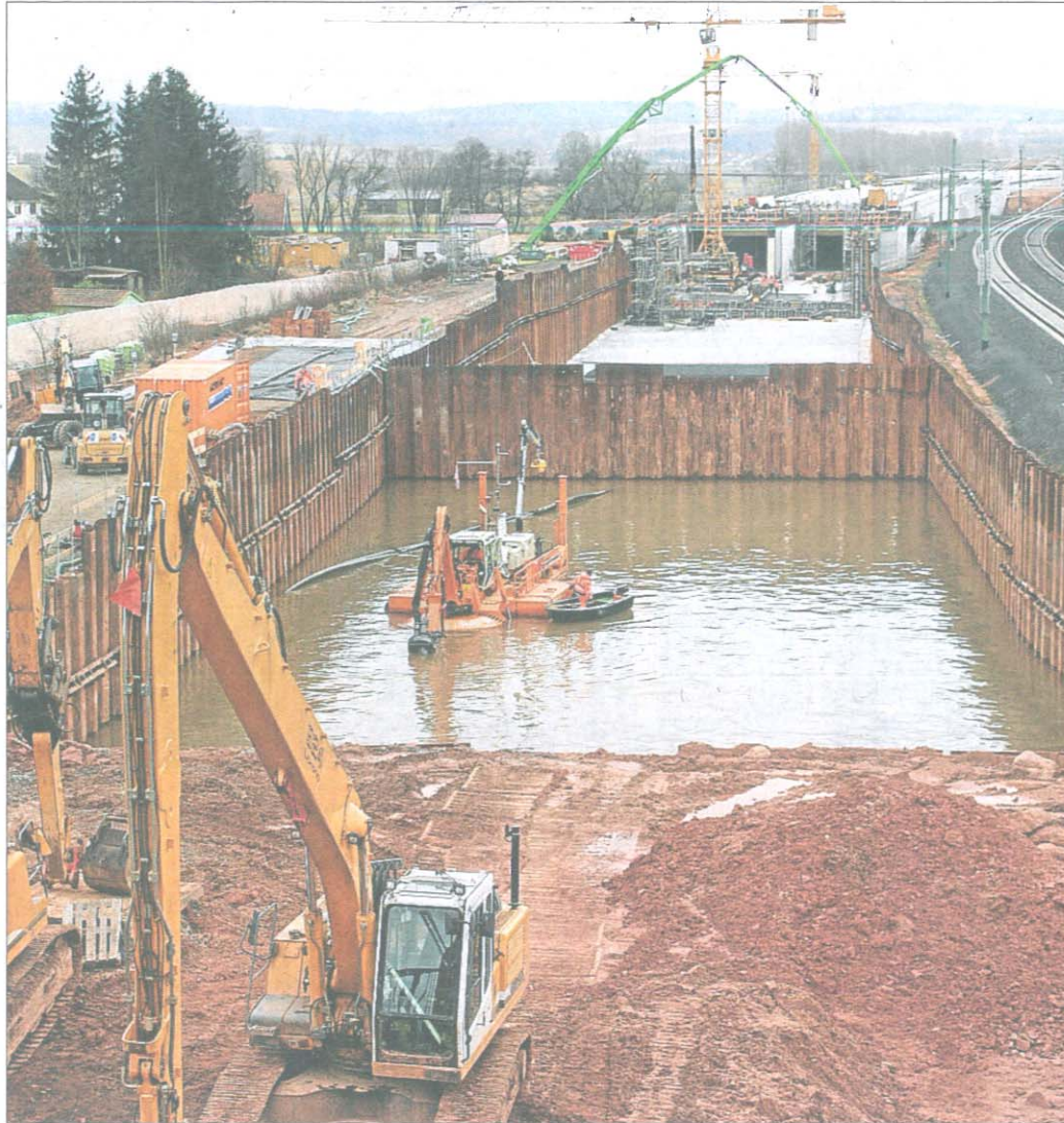
Ungewöhnlicher Anblick: Auf der Baustelle in Neuhof steht die Baugrube – absichtlich – unter Wasser und wird sogar mit einem Boot befahren. Foto: Anne Kramer
