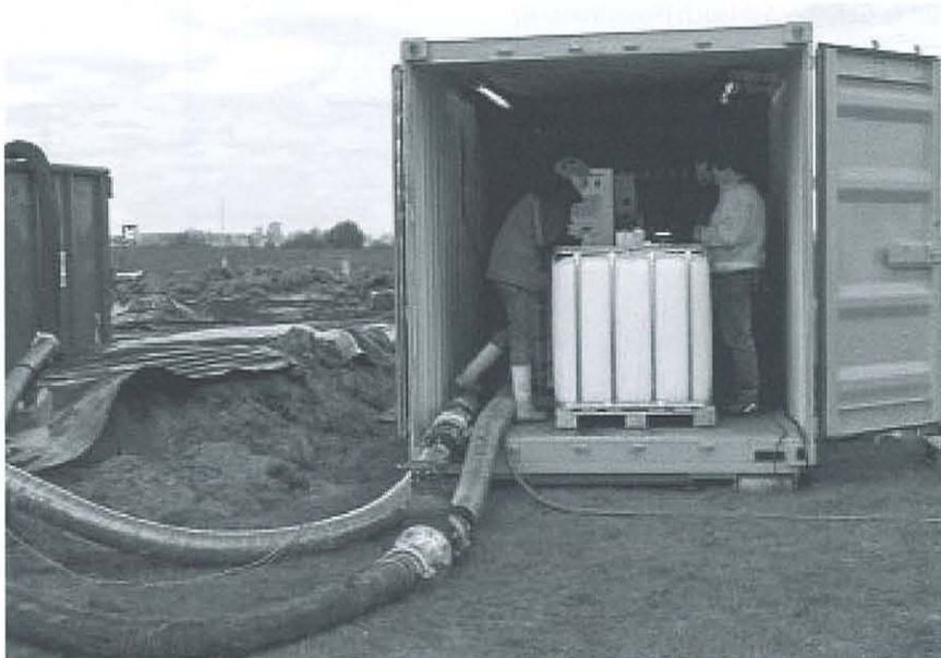
Bild 2: Flockmaster provisorisch eingebaut in einen Container
