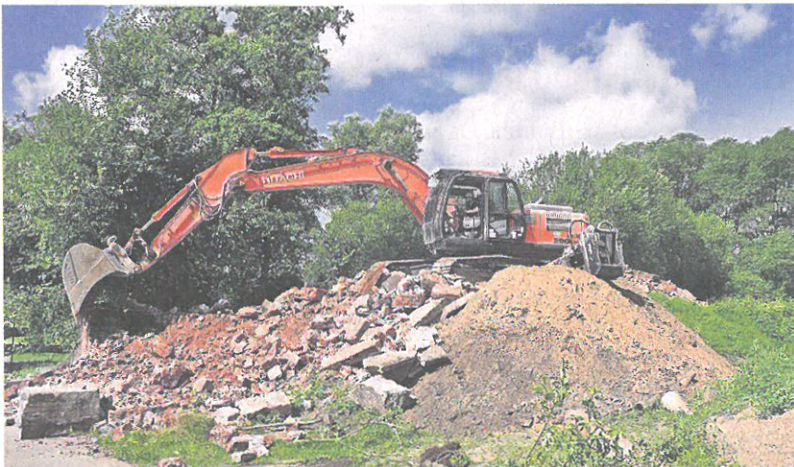
Nur noch ein Schuttberg vom Sockel am Westufer der Oste...
