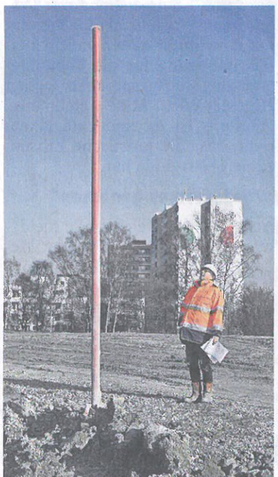
Bauleiter Wilfried Hirschmann neben einem von fünf Setzungsmesspegeln.
