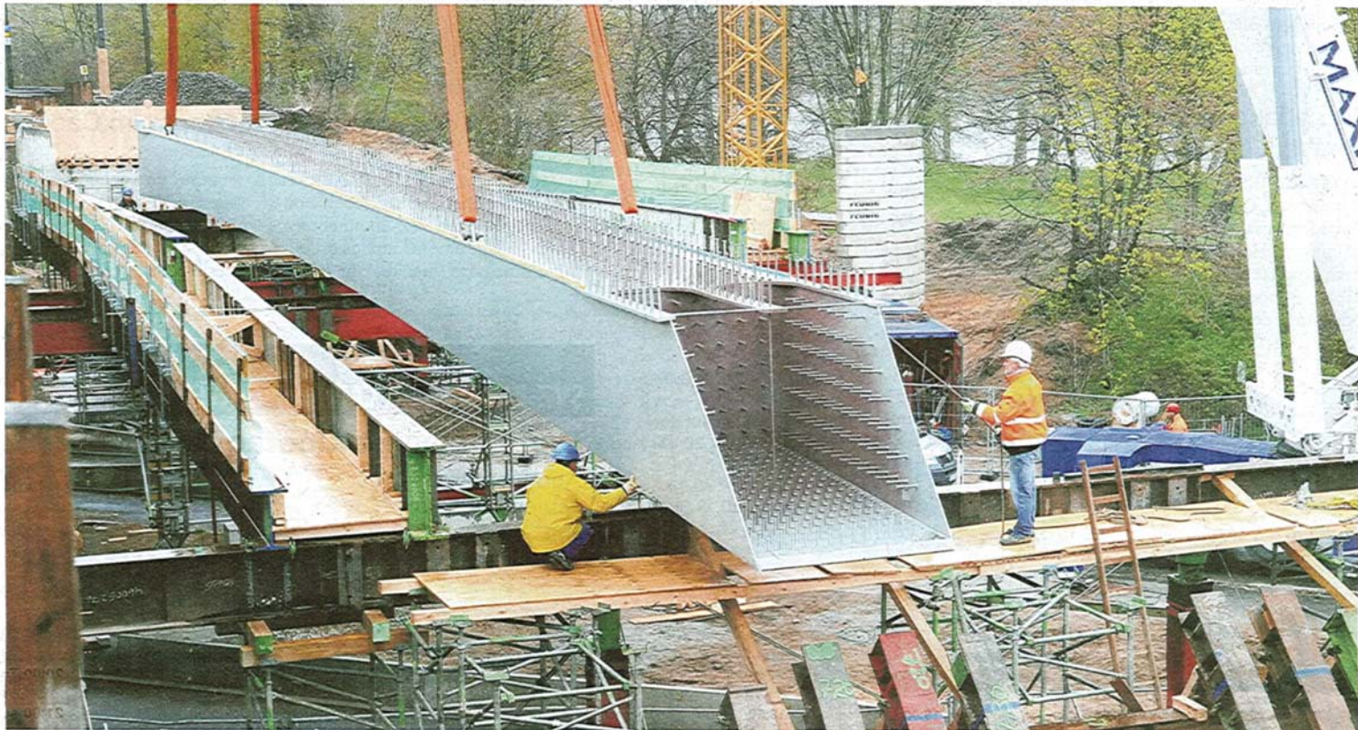
Maßarbeit in der Crivitzer Chaussee: Mit einem überdimensionalen Kran wurden gestern die Stahlträger der neuen Straßenbahnbrücke aufgelegt.
